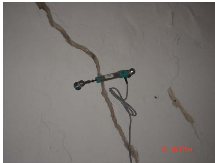
Figura 19.- Instrumentación de una grieta.
