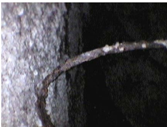
Parte final de armadura que une ambas paredes (pared interior). Se observa que al llegar a la pared interior la armadura se arquea.
