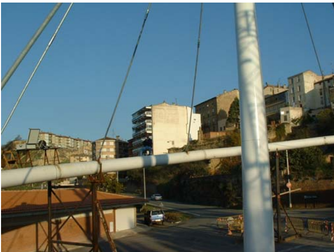
Descenso de los gatos hidráulicos hasta que la estructura que de en el aire
