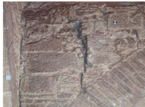
Referencia fisuración en obra de fábrica
