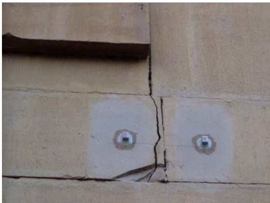
Referencia fisuración en obra de fábrica
