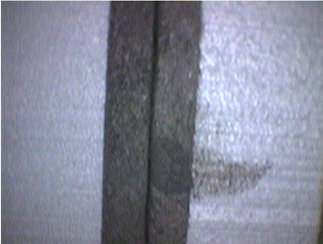
Detalle de una infiltración de agua a la cámara situada bajo el nº 32 a través del forjado de techo que soporta el jardín
