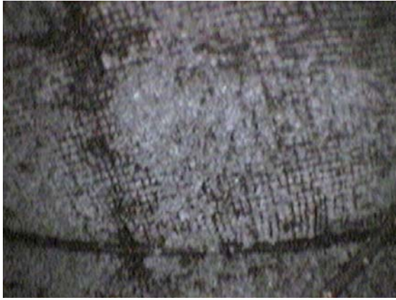
Pared de salida al mirador con tela metálica y armadura horizontal con corrosión
