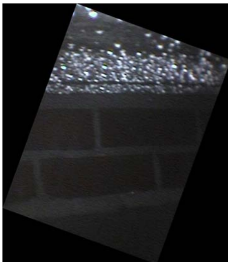
Agua en la cara inferior del forjado de techo de la cámara situada bajo el jardín del n° 30
