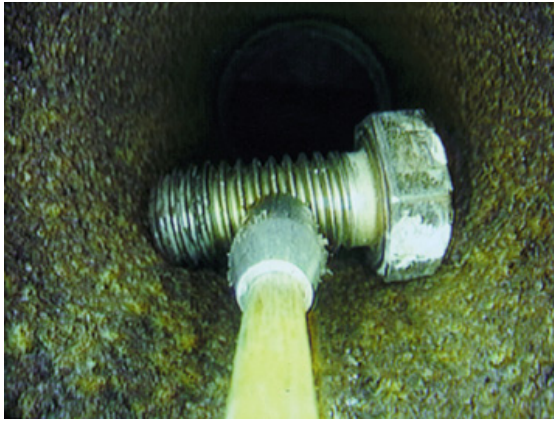
Tornillo olvidado dentro de una tubería.
